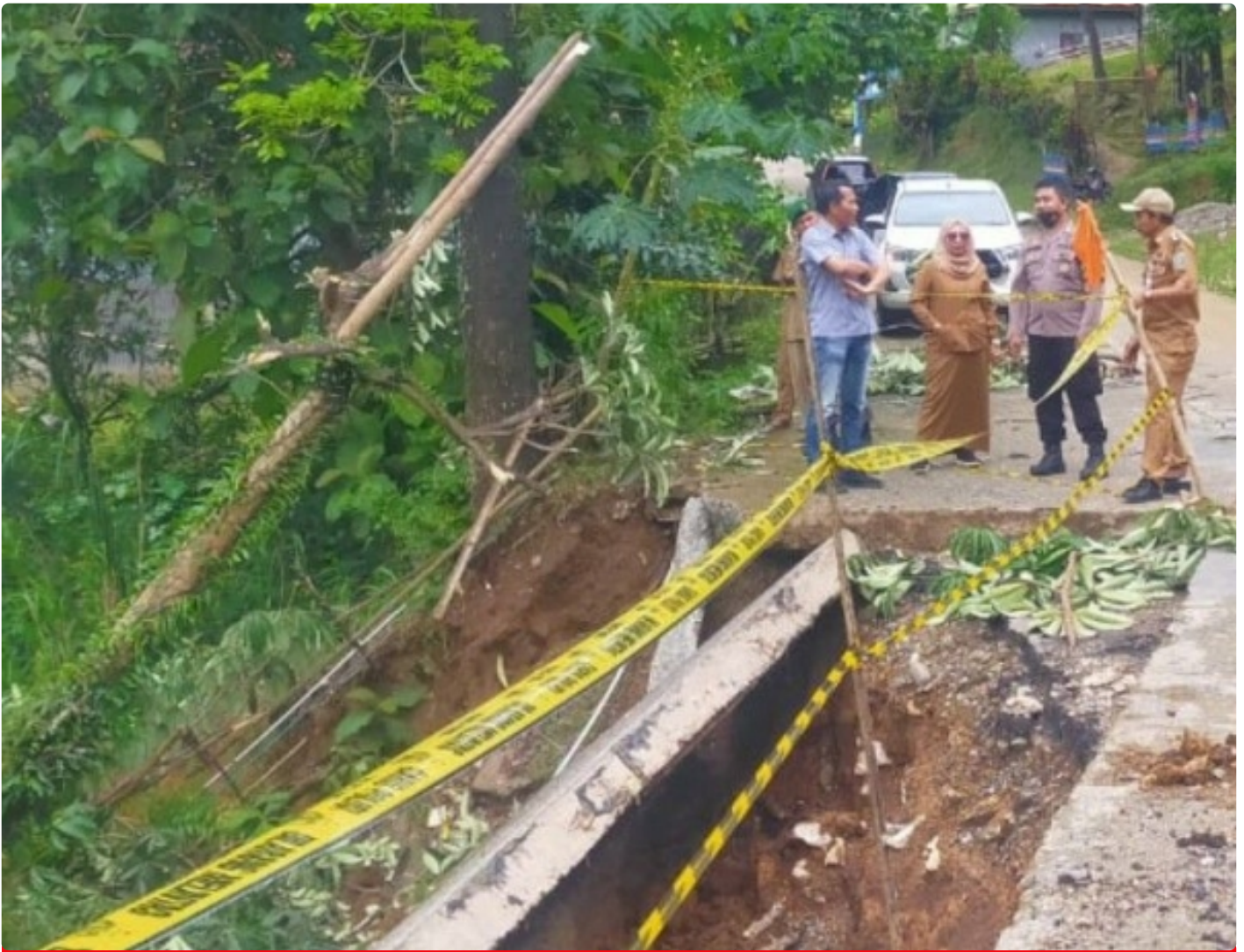
Dinas PU Provinsi Sulawesi-Selatan tinjau Akses jalan poros Provinsi Tabora Tondong Tallasa longsor
